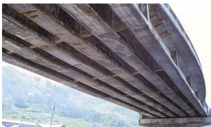
写真 ひび割れ・錆汁・剥離
