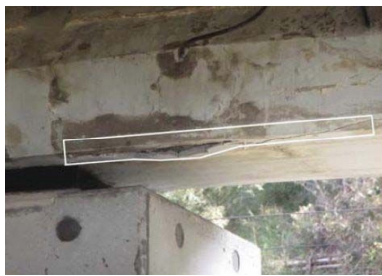
写真 PC桁橋の剥離
