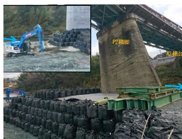
写真 H30.10豪雨 橋脚洗掘通行止め
