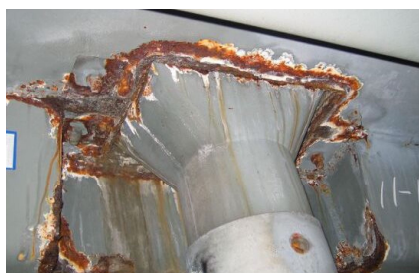
写真 排水樹の破損による漏水
