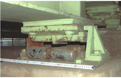
写真 ローラーの破損による機能障害 (鋼製)
