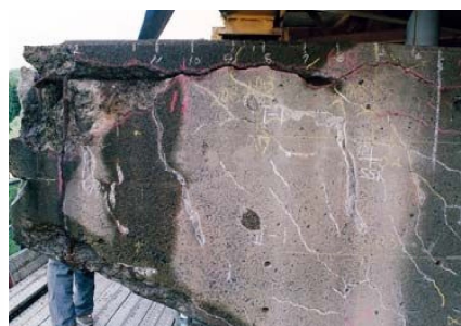
写真 張出し部の著しい損傷
