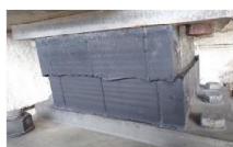
支承が破断した事例
