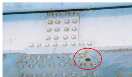
写真 脱落したボルト
