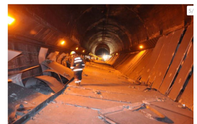
トンネル崩落事故状況
