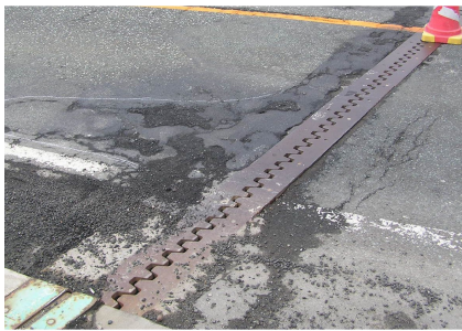
写真 ポットホール
