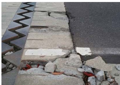
写真 後打ちコンクリートの破損
