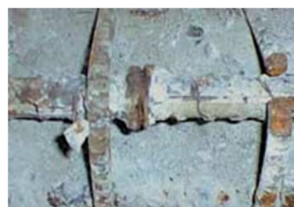
写真 膨張圧による鉄筋破断
