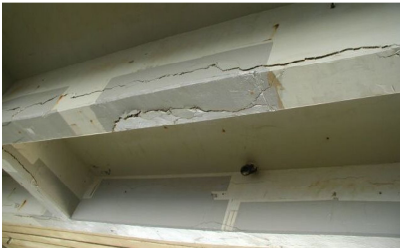
写真 ひび割れ幅が大きく間隔が小さい
