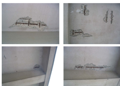
写真 床版コンクリートの剥離
