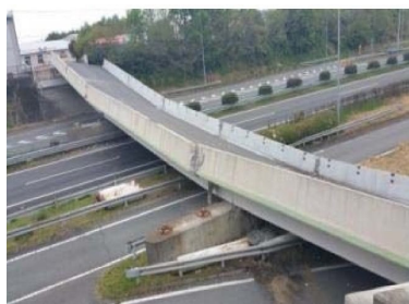
写真 2016.4 熊本地震高速道路 跨道橋落橋
