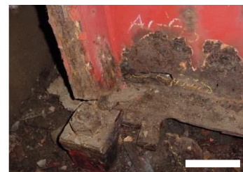
写真 腐食による欠損
