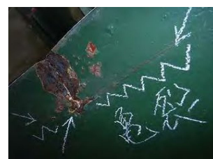
写真 疲労亀裂での破断
