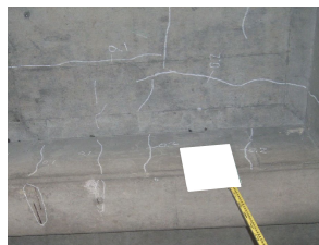
写真 ひび割れ
