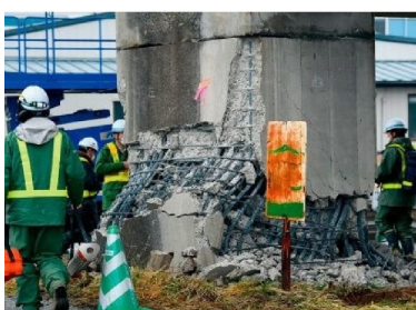
写真 2022.3 福島沖地震 新幹線橋脚 破壊
