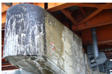
写真 橋脚梁部のASRによるひび割れ
