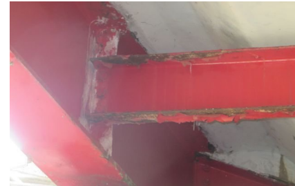
写真 床版からの漏水による腐食
