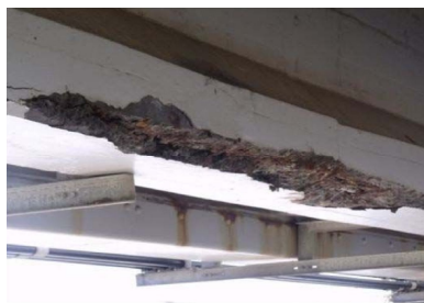
写真 PC桁橋の剥離
