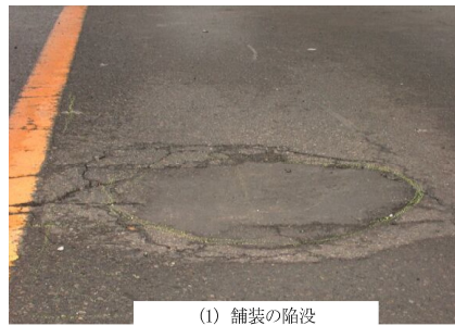
(1) 舗装の陥没 写真 舗装の陥没
