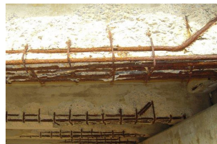
写真 剥離・鉄筋露出
