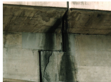
写真 ひび割れ・漏水
