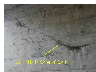
写真 コールドジョイント
