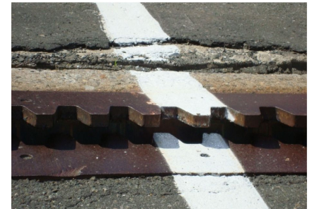
写真 路面の段差(伸縮装置破損)
