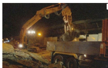
トンネル崩落事故状況
