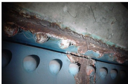
写真 床版からの漏水による腐食
