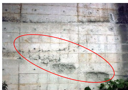
写真 橋台側面剥落状況
