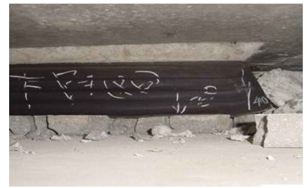
写真 ゴムの異常変形による 機能障害 (ゴム)
