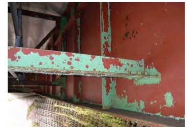
写真 塗膜の劣化
