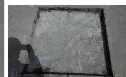
床版上部で一部浮きを確認したが、概ね健全であった。
