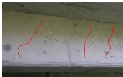
写真 斜めひび割れ
