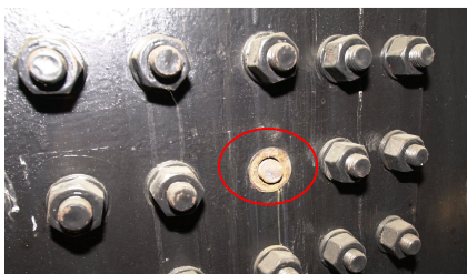
写真 脱落したボルト
