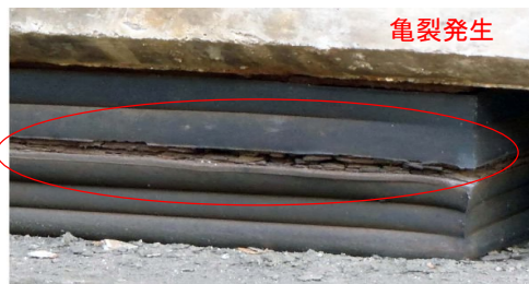
写真 パット型支承の鋼材腐食
