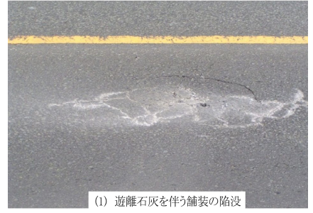
(1) 遊離石灰を伴う舗装の陥没 写真 遊離石灰を伴う陥没
