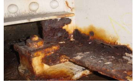
写真 腐食による機能障害 (鋼製)
