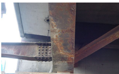
写真 著しい板厚減少ではない
