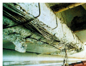
写真 剥離・鉄筋露出
