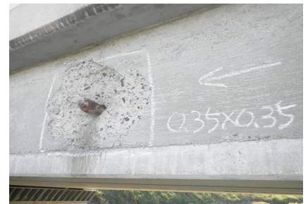
写真 PC鋼材突出事例 (I桁)
