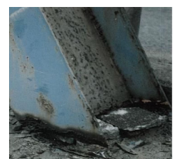
写真 疲労亀裂での破断
