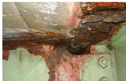
写真 床版からの漏水による腐食
