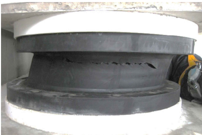
写真 ゴムの破損による機能障害 (ゴム)
