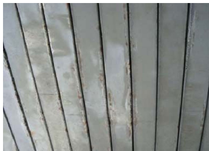
写真 幅0.5mmのひび割れ
