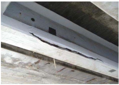
写真 PC桁橋のひび割れ
