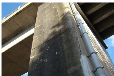
写真 橋脚柱部のASRによるひび割れ
