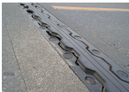
写真 ゴム伸縮の破損
