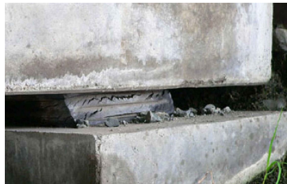
写真 ゴムのオゾン劣化と想定される 機能障害 (ゴム)
