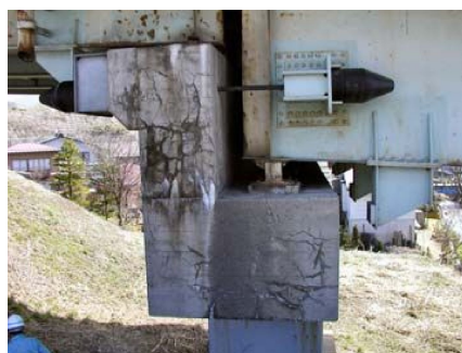
写真 亀甲状クラック
