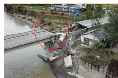
写真 橋台背面盛土の浸食
