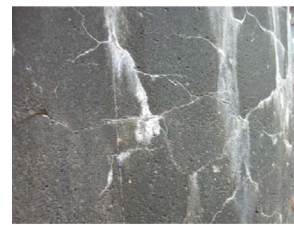
写真 ひび割れ
