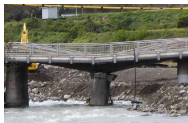
写真 橋脚基礎の洗堀による沈下
