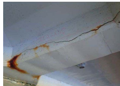
写真 補修補強材からの錆汁
