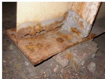
写真 主桁フランジの腐食減肉
