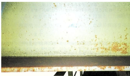
写真 錆が生じている事例 (板厚減少が確認できない)
