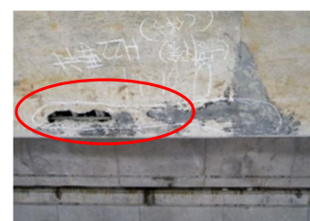
写真 内部空洞
