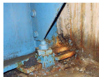
写真 支承の変形
