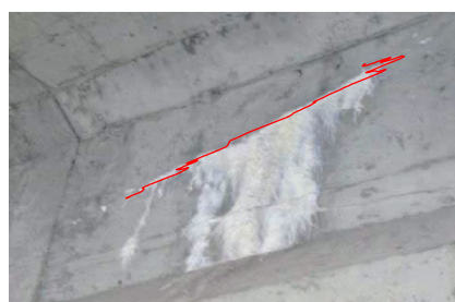
写真 PCT桁ウエブからの遊離石灰
