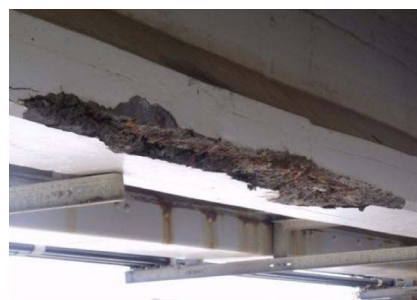
写真 補強材の損傷(剥落)
