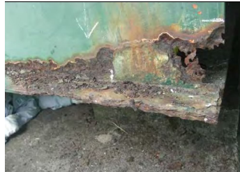
写真 腐食による欠損
