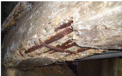
写真 鉄筋が著しく腐食している
