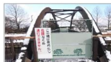
橋の通行制限
