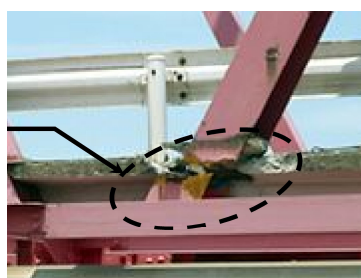
写真 コンクリート接触部の腐食による破断
