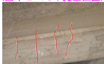
写真 軸直角方向ひび割れ
