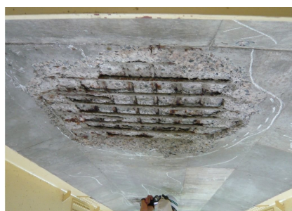
写真 床版下面の剥落
