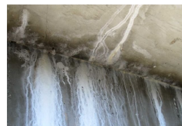
写真 エフロレッセンス
