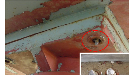
写真 ボルトの緩み脱落
