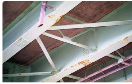
写真 錆が生じている事例 (板厚減少が確認できない)
