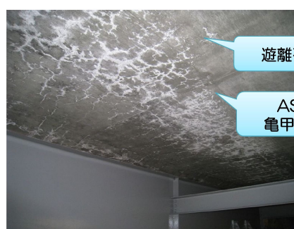
写真 亀甲状クラック
