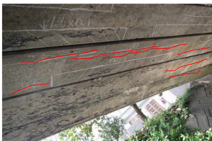
写真 PC桁下面の橋軸方向ひび割れ
