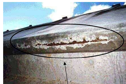
写真 壁高欄の剥離
