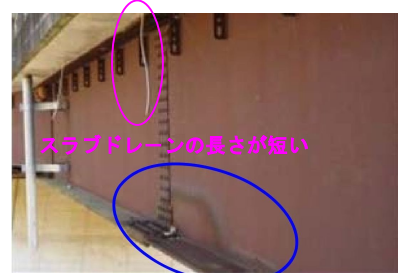
写真 スラブドレーンからの漏水
