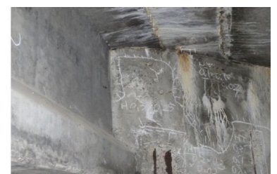
写真 漏水・遊離石灰
