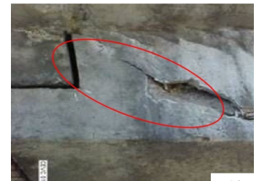
写真 ひび割れ・破断
