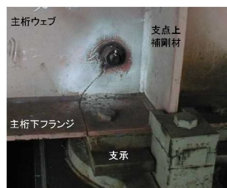
写真 疲労亀裂 損傷状況
