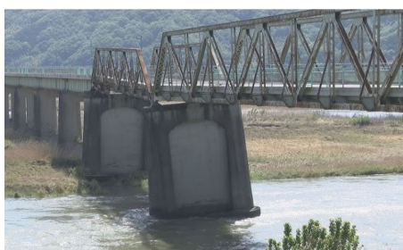
写真 基礎の洗堀
