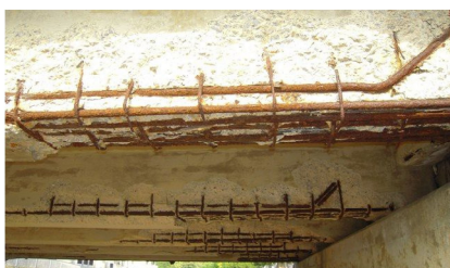
写真 広範囲に鉄筋露出し鉄筋も著しく腐食している
