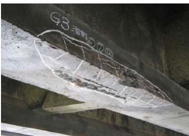
写真 PC桁橋の浮き
