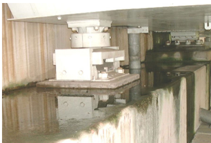
写真 伸縮部からの漏水
