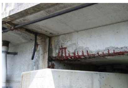
写真 剥離・鉄筋露出
