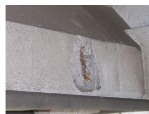
写真 剥離・鉄筋露出
