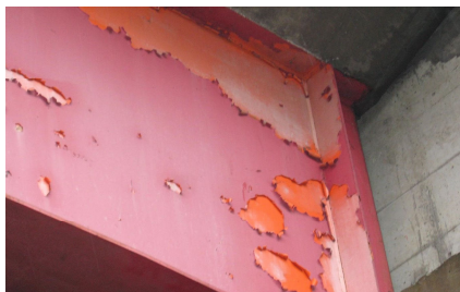
写真 塗膜が変色した事例
