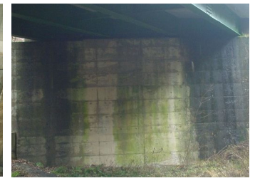
写真 漏水による変色
