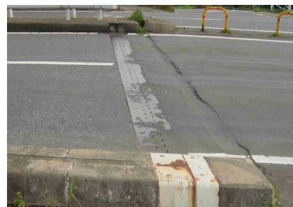
写真 路面の凹凸
