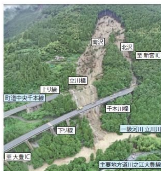
写真 2018.7 豪雨(土石流) 高知自動車道 立石橋崩落
