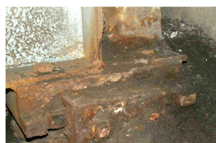
写真 桁端部及び支承部の腐食
