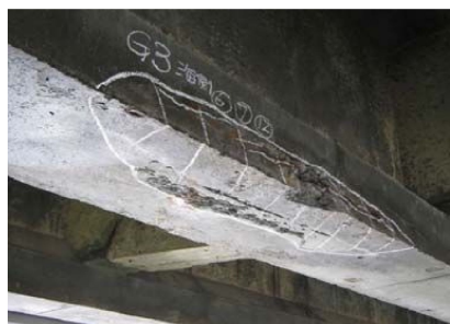
写真 ひび割れ・浮き・剥離・鉄筋露出
