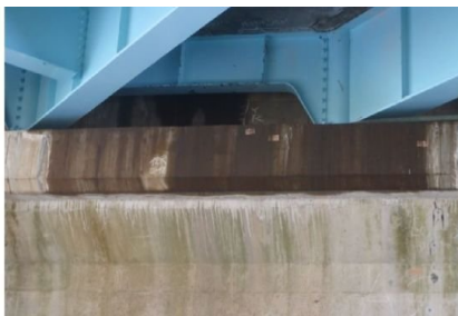
写真 伸縮部からの漏水
