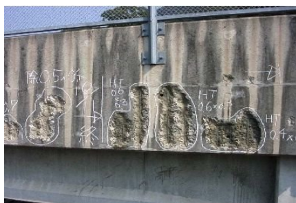
写真 壁高欄の剥離
