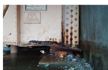
支点部の主桁が座屈した事例
