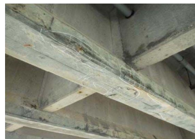
写真 PC桁橋の浮き
