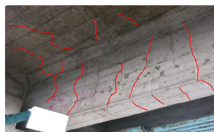
写真 斜めひび割れ
