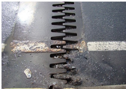
写真 遊間異常(遊間が広い)
