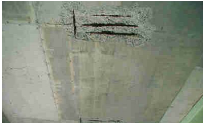
写真 鉄筋露出しているが局部的腐食も軽微
