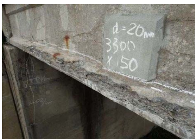
写真 PC桁橋の剥離
