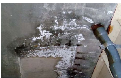
写真 床版排水樹周辺からの漏水
